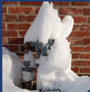
MEDIDOR SIN PROTECCIÓN PARA NIEVE
